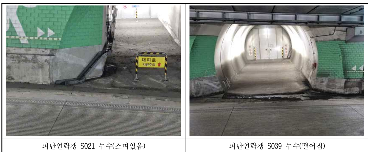
【사진 3.3.38】 피난연락갱 손상현황
