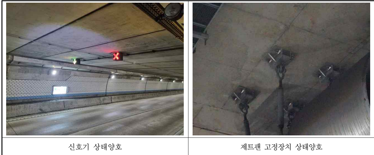
【사진 3.3.44】 기타시설 손상현황
