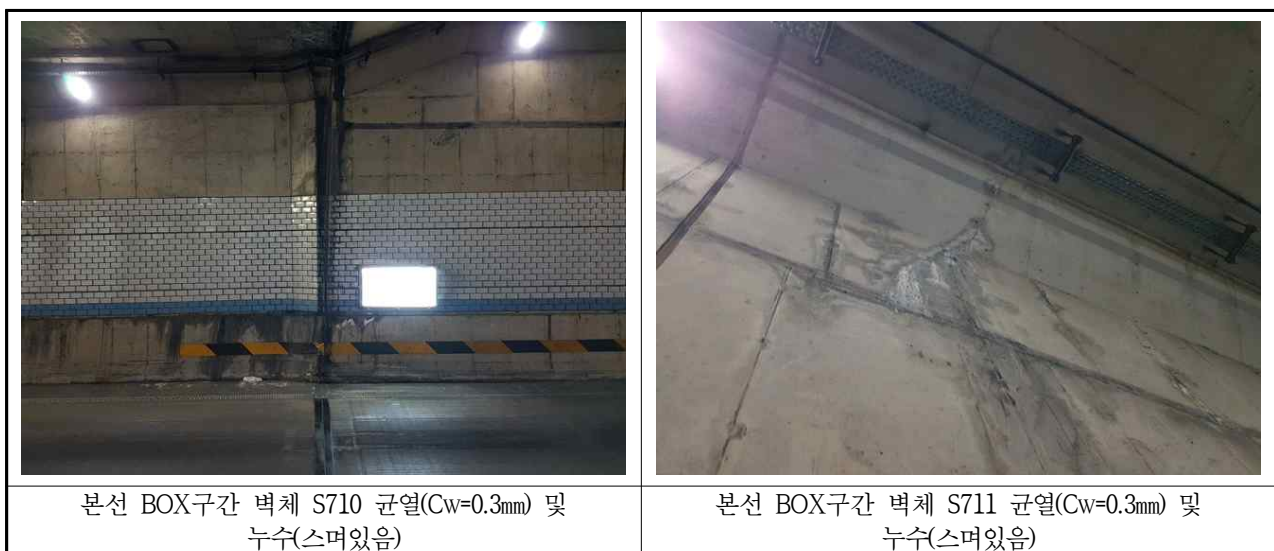
【사진 3.3.4】 BOX구간 벽체 손상현황
