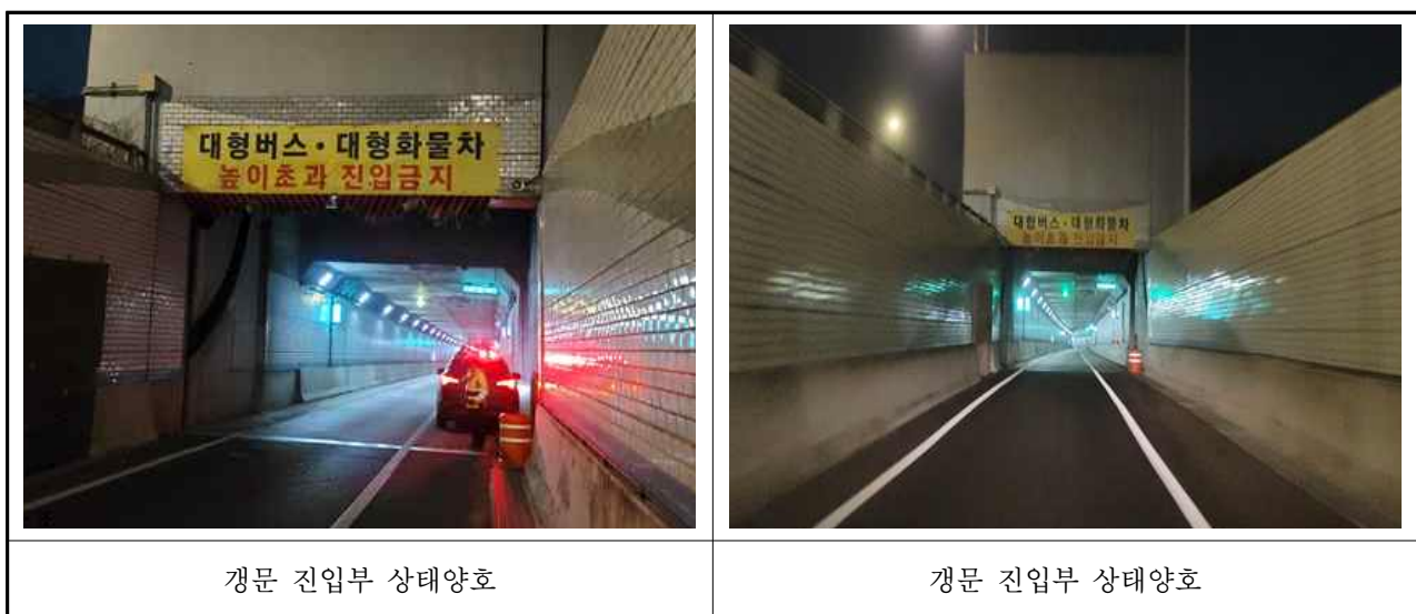
【사진 3.3.36】갯문 손상현황
